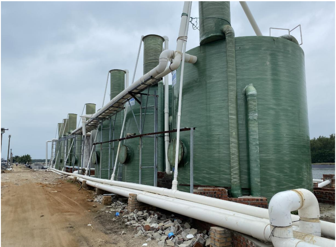
图 5-1 项目现场海水过滤器图片
